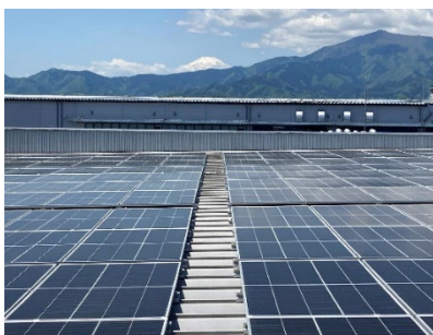
<海老名工場：太陽光パネル>
