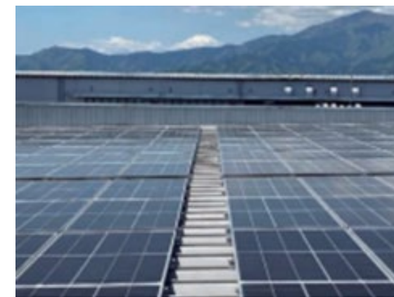
太陽光発電設備（海老名工場）
