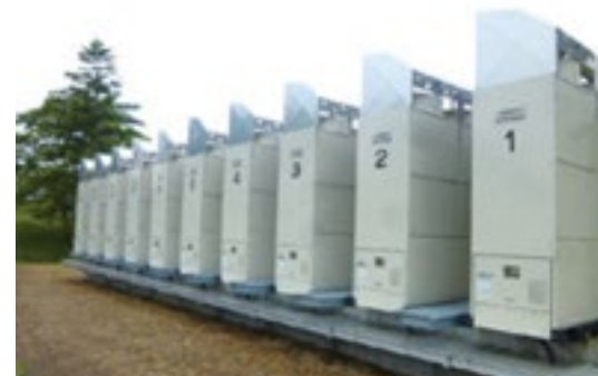
なかしべつ工場の冷凍機
