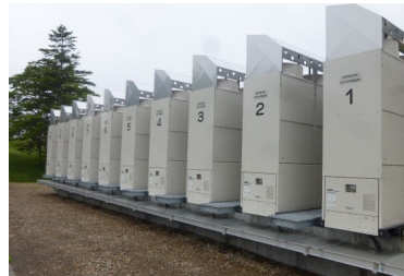
生乳受け入設備（クーラーステーション）に新設した 省エネルギーの冷凍機
