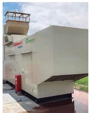
非常用発電機(大樹工場)
