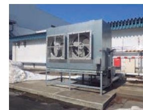
フリークーリング設備
