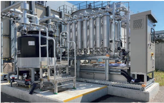
ろ過器逆流水回収設備 (海老名工場)
