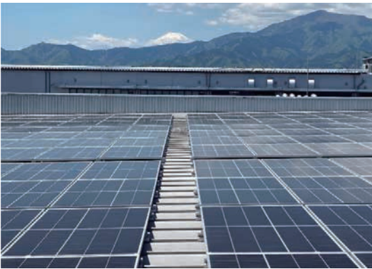
太陽光発電設備(海老名工場)
