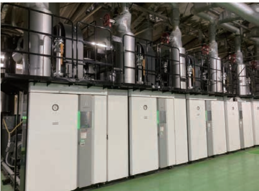
ボイラ設備(大樹工場)
