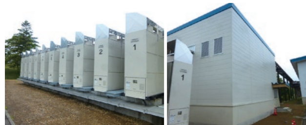
冷凍機(なかしべつ工場)
