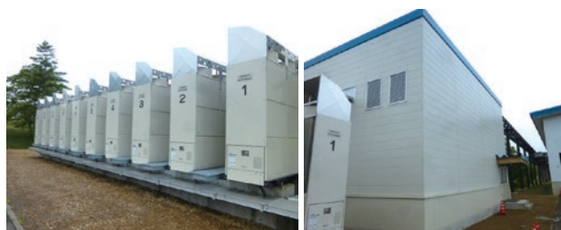
冷凍機(なかしべつ工場)
