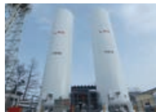
液化天然ガス貯蔵タンク
