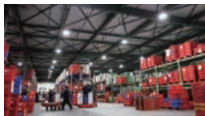
高天井用人感センサー付きLED照明
