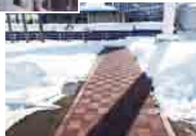
融雪用ロードヒーティング設備(歩道下)
