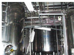
被災した設備(みちのくミルク(株))
