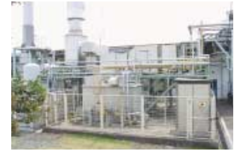
コージェネレーション設備(厚木工場)
