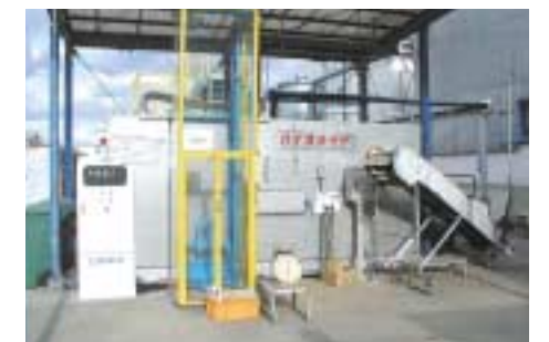
コンポスト設備(関西チーズ工場)
