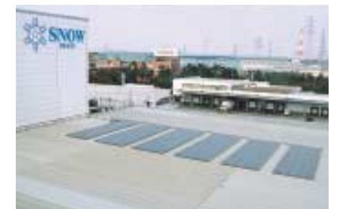
太陽光発電設備(野田工場)
