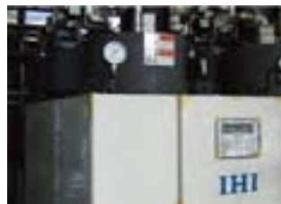
名古屋工場 ボイラー
