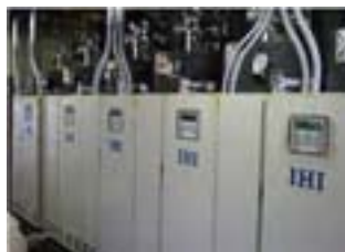
野田工場 ボイラー
