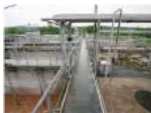
排水浄化設備
